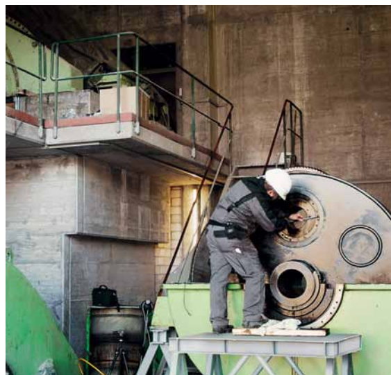
Капитальный ремонт после 37 лет непрерывной работы показал, что центральный привод находится в весьма хорошем состоянии
